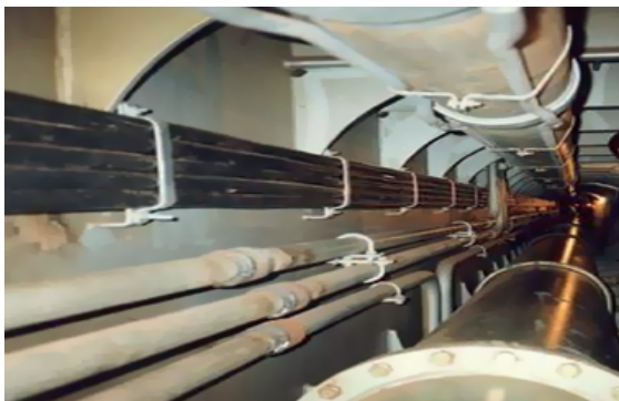
Трубные пучки, установленные на судне
