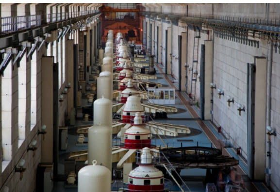
МАШИННЫЕ ЗАЛЫ, ОПЕРАТОРНЫЕ
